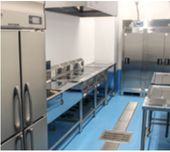
中央学校給食センター内に整備されている特別調理室
