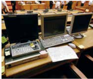
インターネット中継システム（山形市議場）
