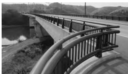
耐震設計がされていないと報告されたマリンブリッジ
