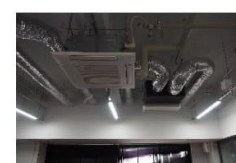
高効率空調・全熱交換器の整備
