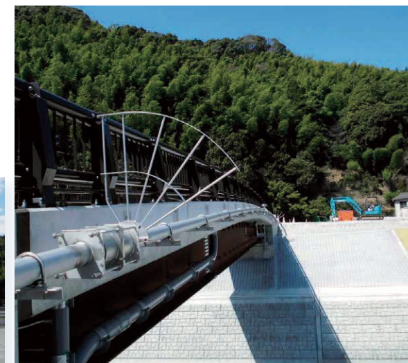
上水道配水管（加茂町）
