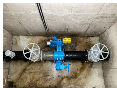
緊急遮断弁(橘配水池)
