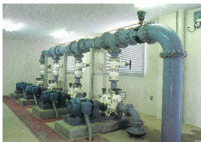
配水ポンプ(西原水源地)
