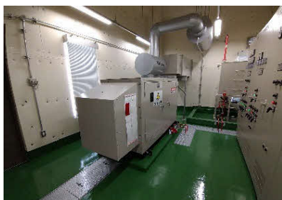
非常用自家発電装置 (加茂谷水源地)
