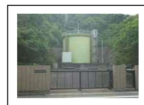
⑧ 小勝配水池
