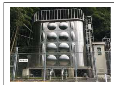
㊺ 熊谷配水池 (令和元年12月 供用開始)
