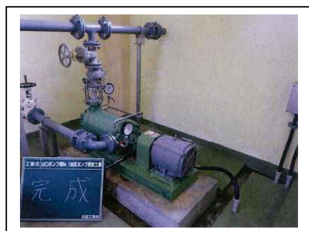
加圧ポンプ(⑱ 山口加圧ポンプ場)
