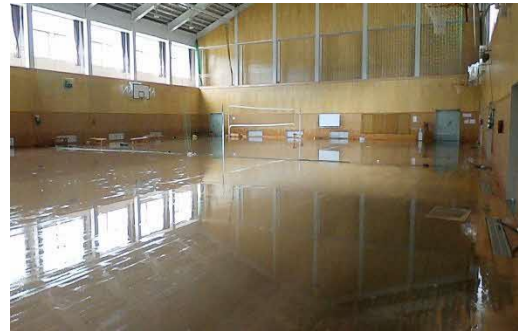
平成 26 年台風 12 号による浸水被害 加茂谷中学校体育館 (平成 26 年 8 月)
