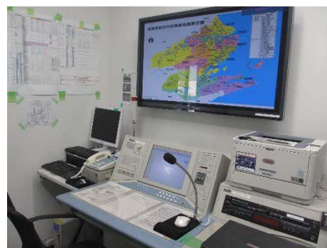
防災行政無線（市役所内）
