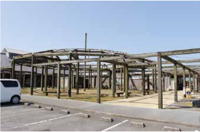
老朽化している道の駅公方の郷なかがわのパーゴラ
